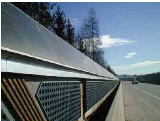
Abbildung 24: Multifunktionale Lärmschutzanlage (MLA) A2 Gleisdorf
